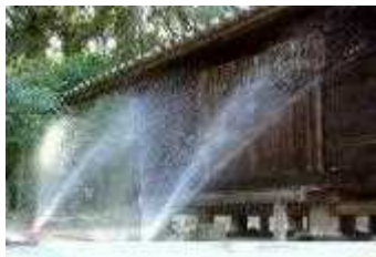
(ドレンチャー設備)
