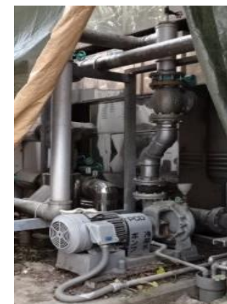
空調設備 (劣化状況)
