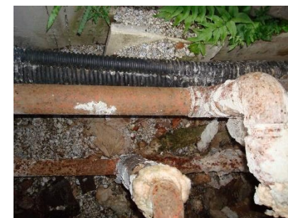
排水設備 (劣化状況)
