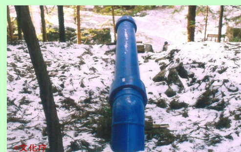
緊急防災施設耐震改修 消火用水利の配管を地震に強いポリエチレン管に変更
