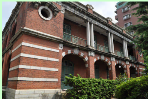
重文: 旧長崎英国領事館 煉瓦造鉄骨大型架構による補強を想定
