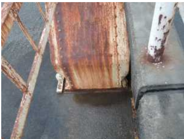
〔参考〕 塗装の剥離, 錆による腐朽 重文・揖斐川橋梁(岐阜)
