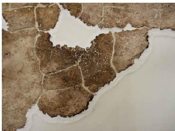
天井 (UV クリーニング前)
