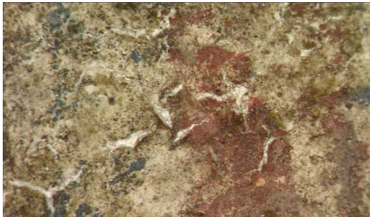
写真 16 バイオフィルムによる漆喰の亀裂
