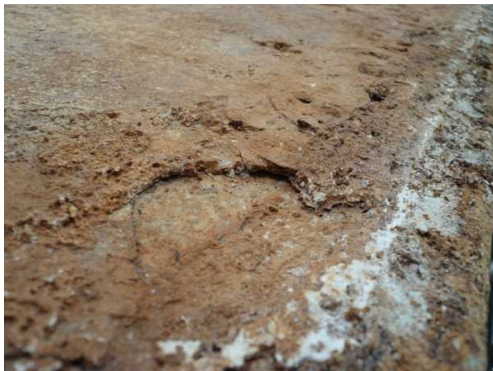
写真 19 漆喰小口の浮き上がりの状況
