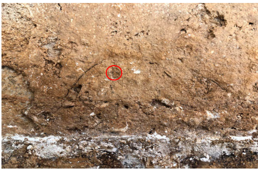
写真1 状態確認箇所 北壁下部
