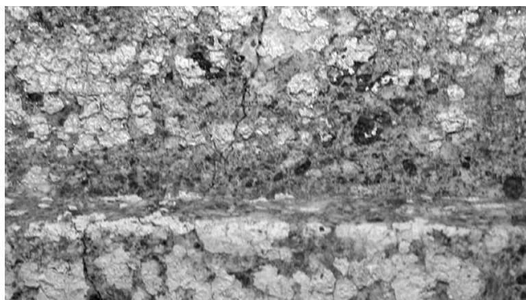
図1.8 床石2の亀裂は、相欠き部分で複雑な状態になっている。また、漆喰も多量に残存する
