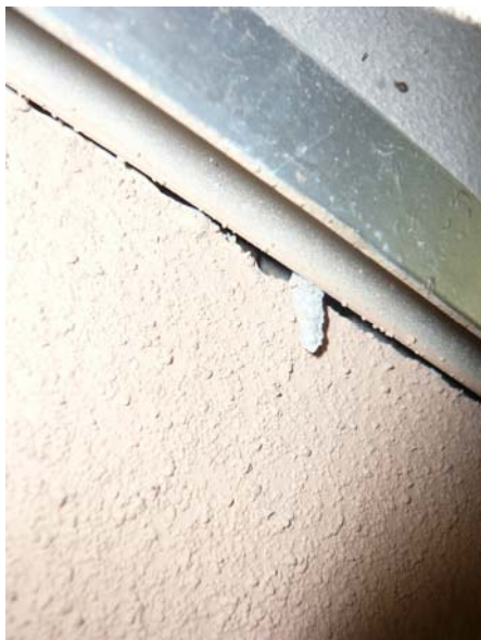
外壁の継ぎ目の隙間
