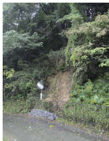
崩落箇所の現在の状況
