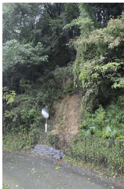
崩落箇所の現在の状況
