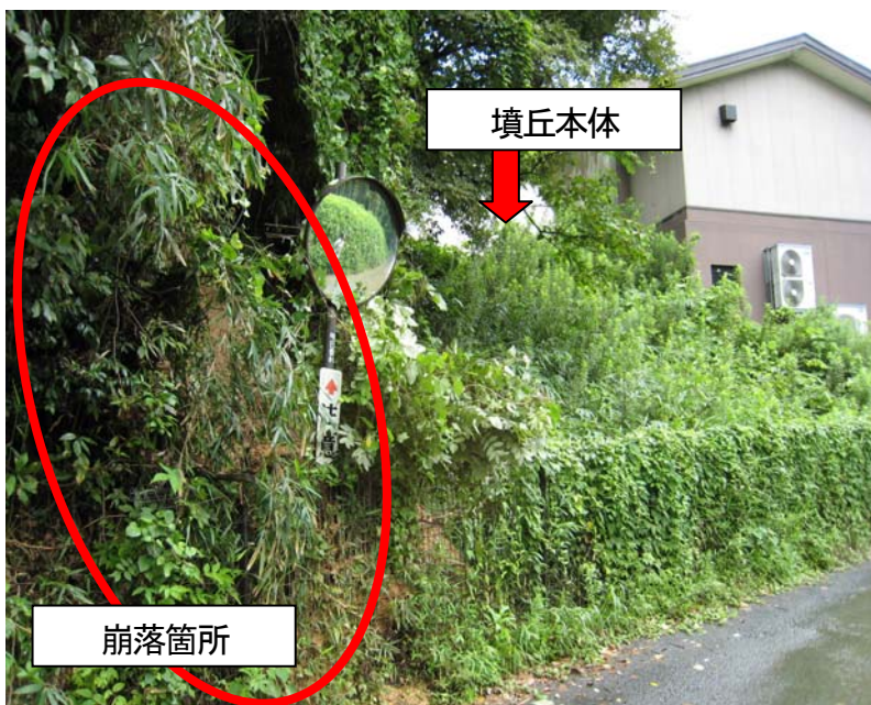
キトラ古墳における崩落箇所の位置関係
