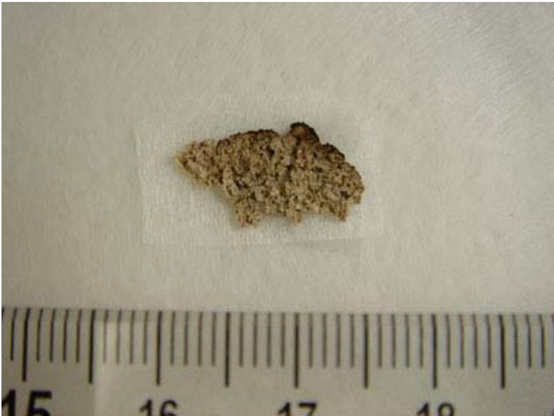
(取り外した天井の漆喰の状態)
