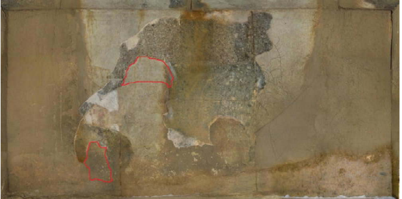
東壁剥ぎ取り箇所
