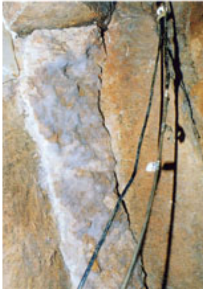
写真 1 - 1 取合部のカビの発生状況 (平成 13 年 3 月)
