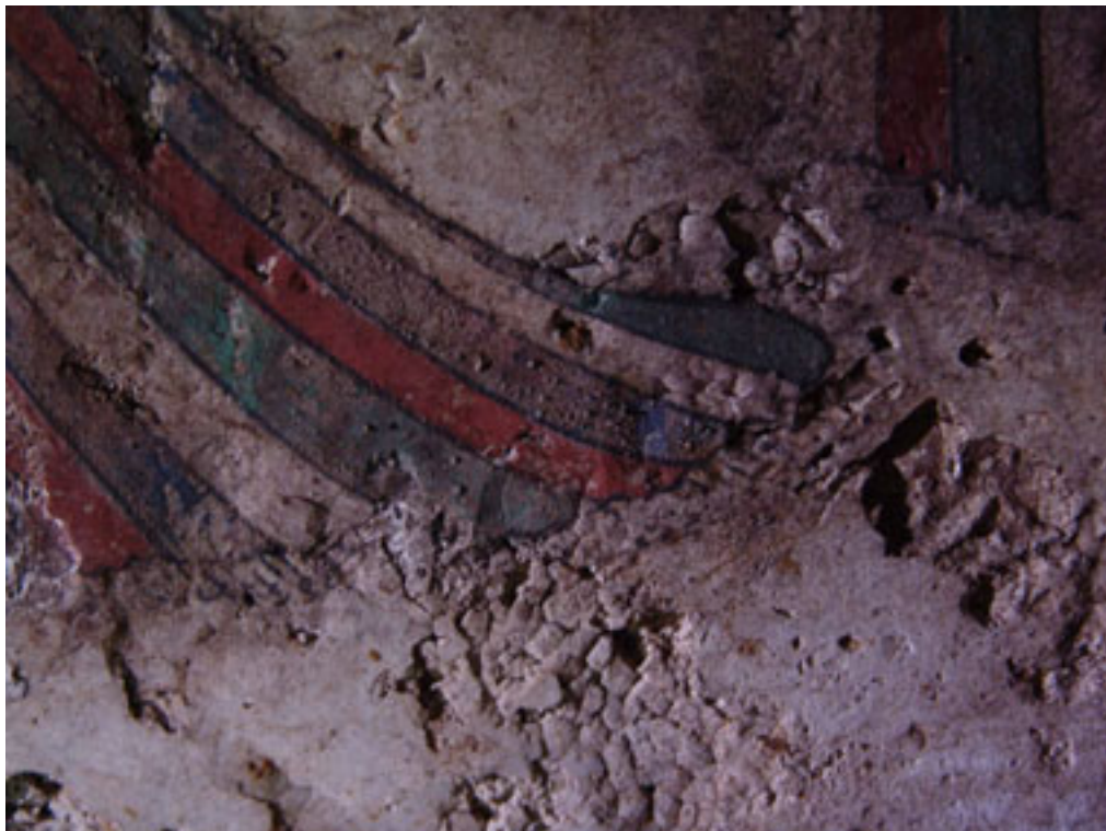
写真 2 - 4 漆喰層内部が中空化し、表層を支えられず陥没している また、中央部に白濁した樹脂が見られる
