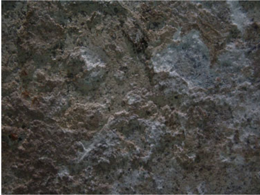
写真 2 - 3 天井漆喰表面の粉状化
