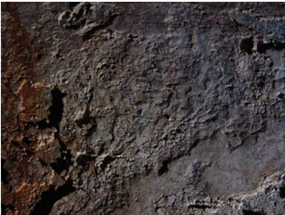
写真 2 - 2 樹脂処置された漆喰層（樹脂の白濁化も見られる）
