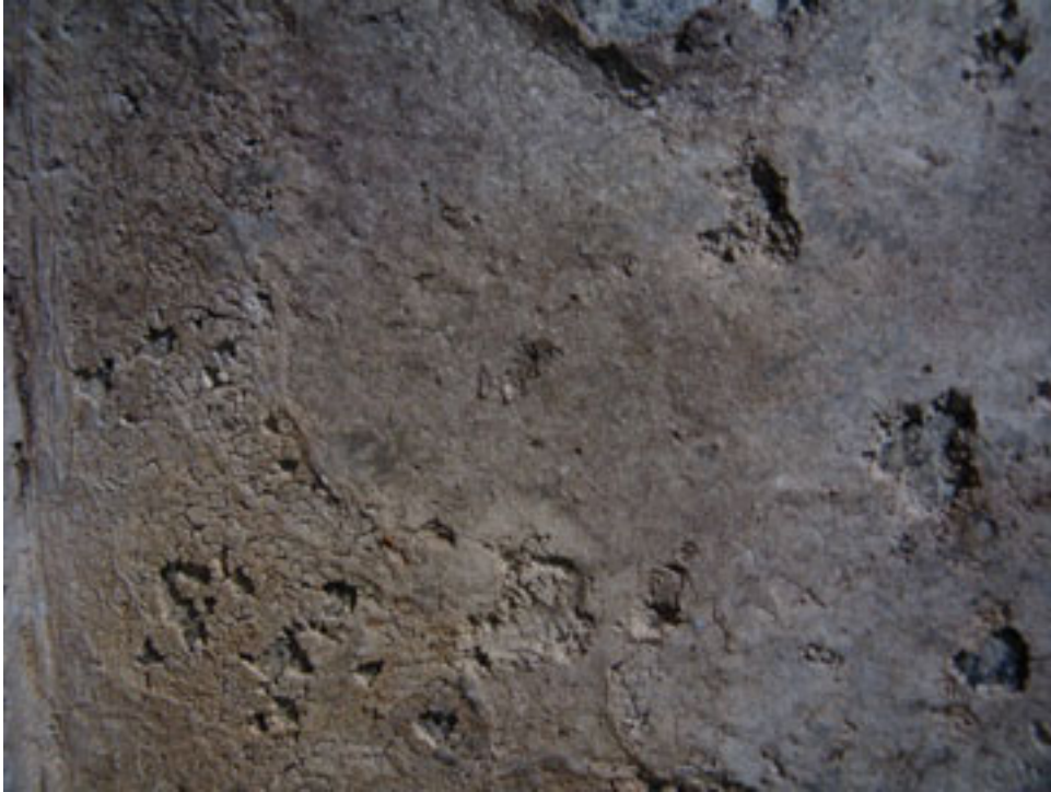
写真 2 - 1 剥離箇所の一例
