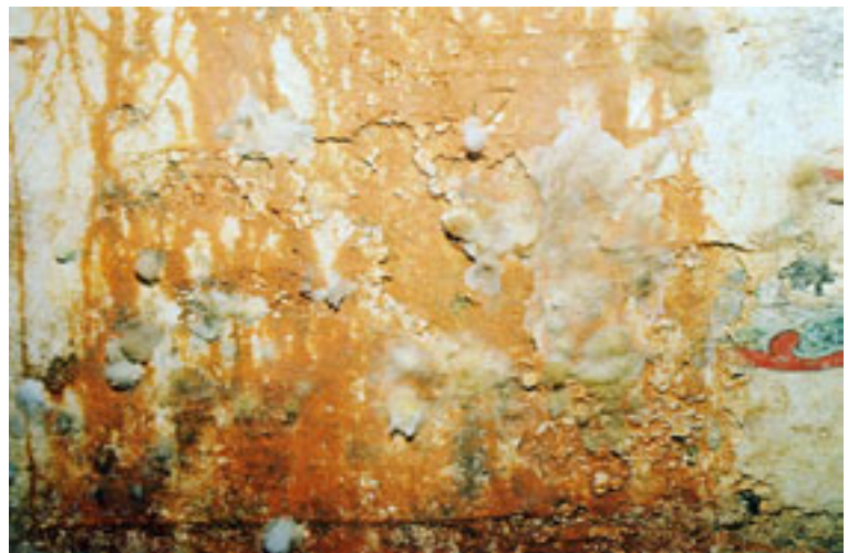
写真 1 - 2 青龍のカビ発生状況 (平成 13 年 12 月)
