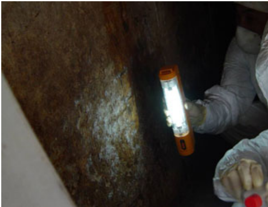
写真 11 . 2004 年 9 月 6-7 日の点検時に発見された西壁群像付近の白いカビの菌糸
