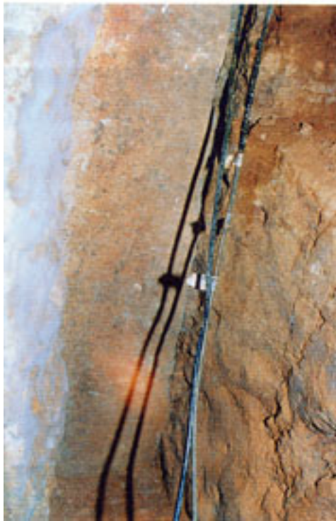
写真1. 取り合い部工事の後，2001年3月25-28日の点検時に取り合い部で発生していたカビの様子 上：石室外側閉塞部上面 中：石室外側上 下：石室外側右側面
