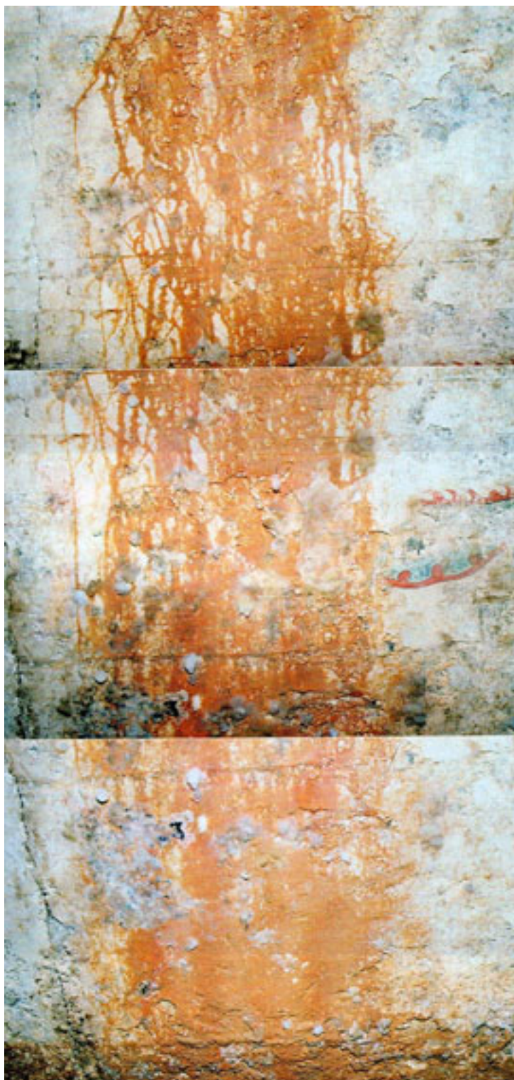
写真3. 2001年12月18-21日の点検時に石室内で発生したカビの様子 東壁青龍付近
