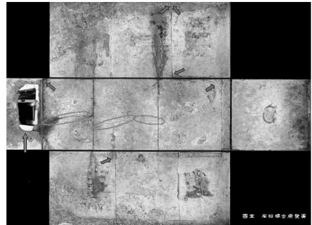
図3-1. 石室内部の石材劣化・損傷箇所
