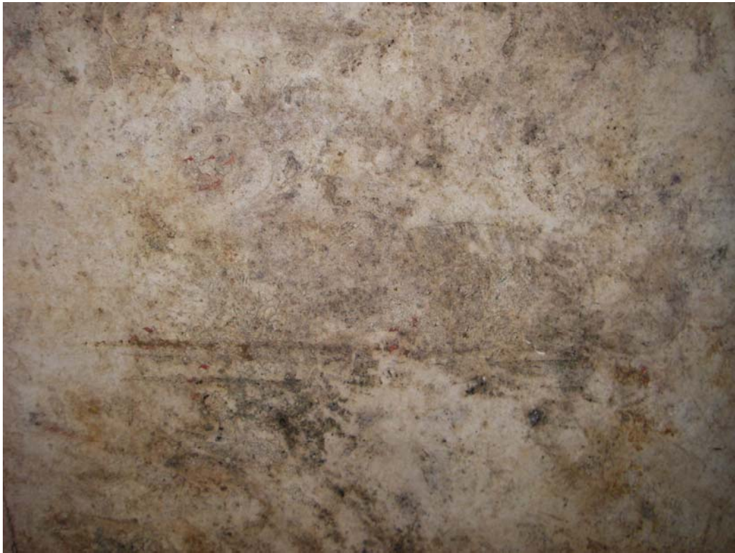
白虎周辺の黒いカビ発生状況（写真1）
