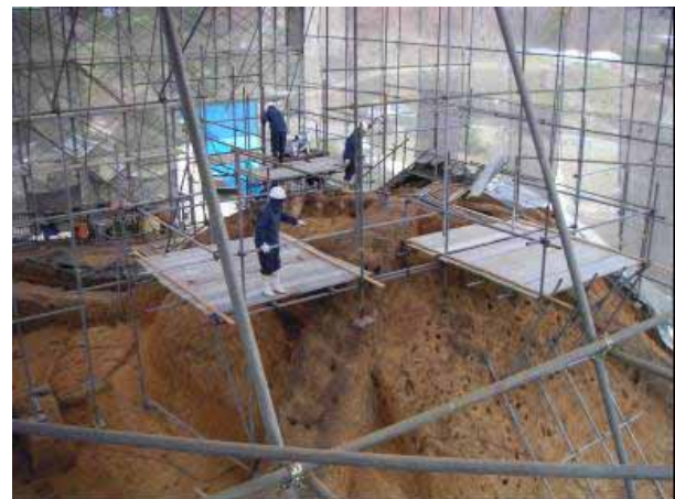
写真-1 試料採取に向けた足場の設営状況（墳丘と石室への影響を避けるために古墳全体を覆う仮覆屋基礎から組み上げている）
