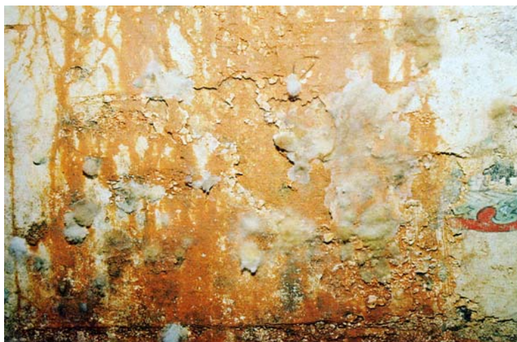
写真 1-2 青龍のカビ発生状況 (平成 13 年 12 月)
