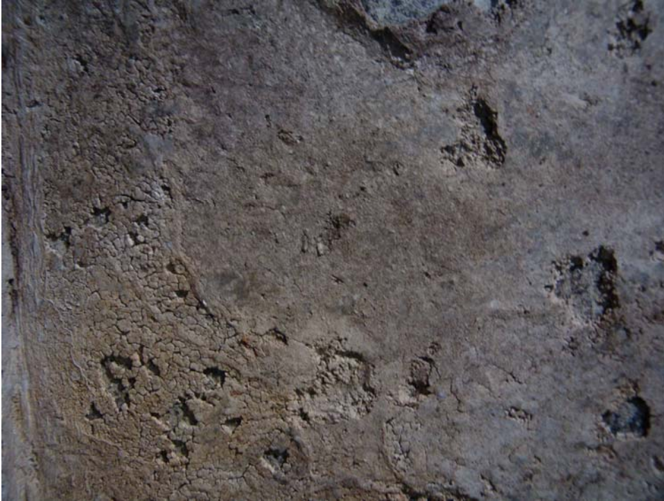
写真 2 - 1 剥離箇所の一例
