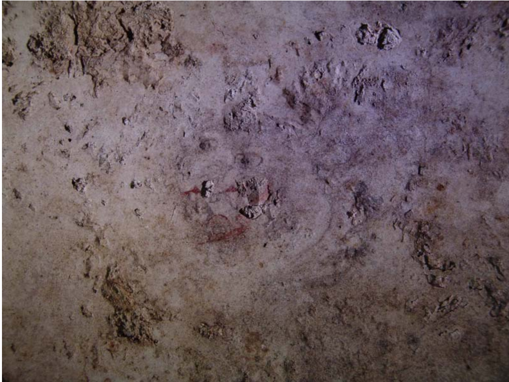
写真 2 - 5 漆喰層内部が中空化し、陥没
