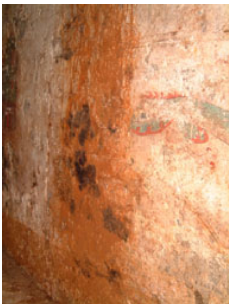
写真 1-3 青龍の黒色カビ発生状況 (平成 14 年 10 月)
