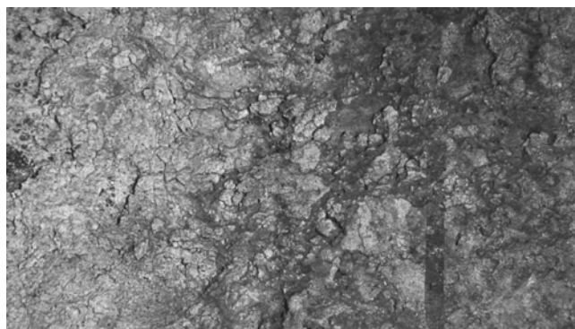
図 1.9 漆喰はブロック状、モザイク状を呈し、剥落寸前の状態にある。わずかな振動によっても大きく剥落する危険性がある。
