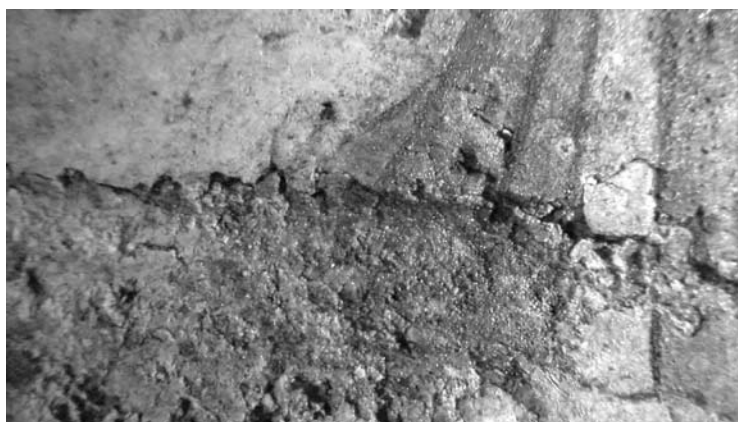
図 1.15 絵画部分は粒状を呈し、かつ強い光沢を有しており、樹脂状物質で処置されているのかもしれない。表層のごく薄い層は固化しているが、内部の粉状を呈する漆喰は固化しておらず、きわめて脆い状態にあると考えられた。
