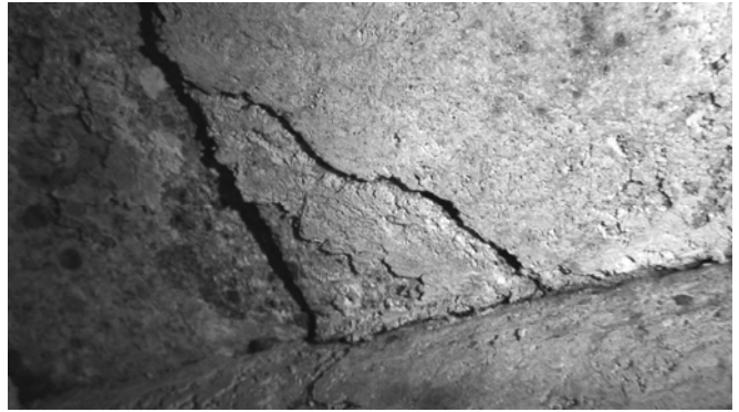
図 1.5 天井石4と東壁石3が接する部分にブロック状の緩やかなカーブを描く割れが見られる。北側はやや高く、天井石3はやや低い。
