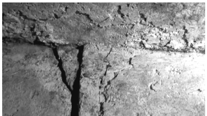
図 1.6 天井石3の取り上げに際して、東壁3、東壁2の上部にまたがる石材のブロック状の複雑な割れについても、落下の危険はある。ただし、漆喰はすでに落下していて残存しない状態にある。
