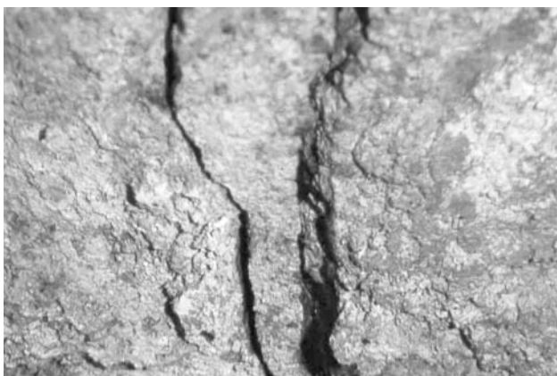
図 1.1 天井石 1 の南北に走る亀裂の中央北部分で、細長いブロック状の複雑に割れた破砕片が挟まれた状態にある。この近辺では、層状を呈する剥離も起こっており、地震によりもまれた痕跡を示しているのかもしれない。
