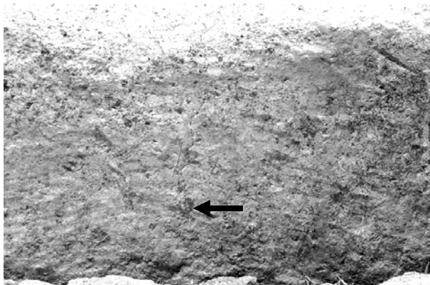
図 2.2 天井石2の西側面に検出された亀裂
