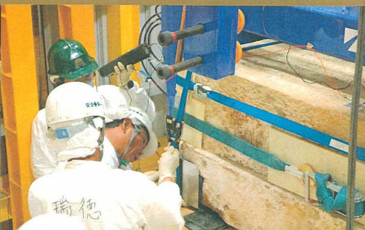
8. 石材の亀裂はベルトやカバーで保護
