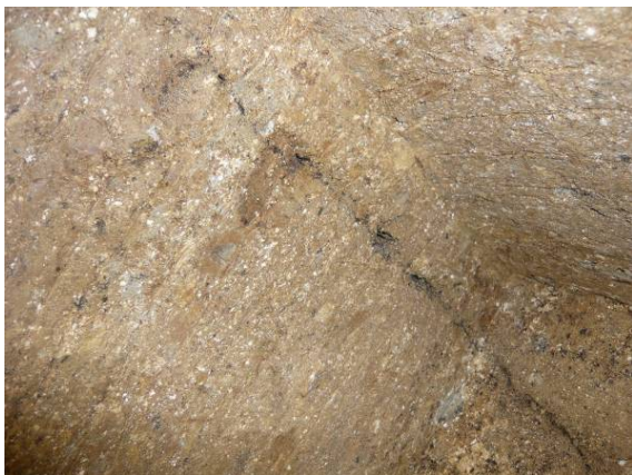
地震痕跡の亀裂の例(2007年8月20日)
