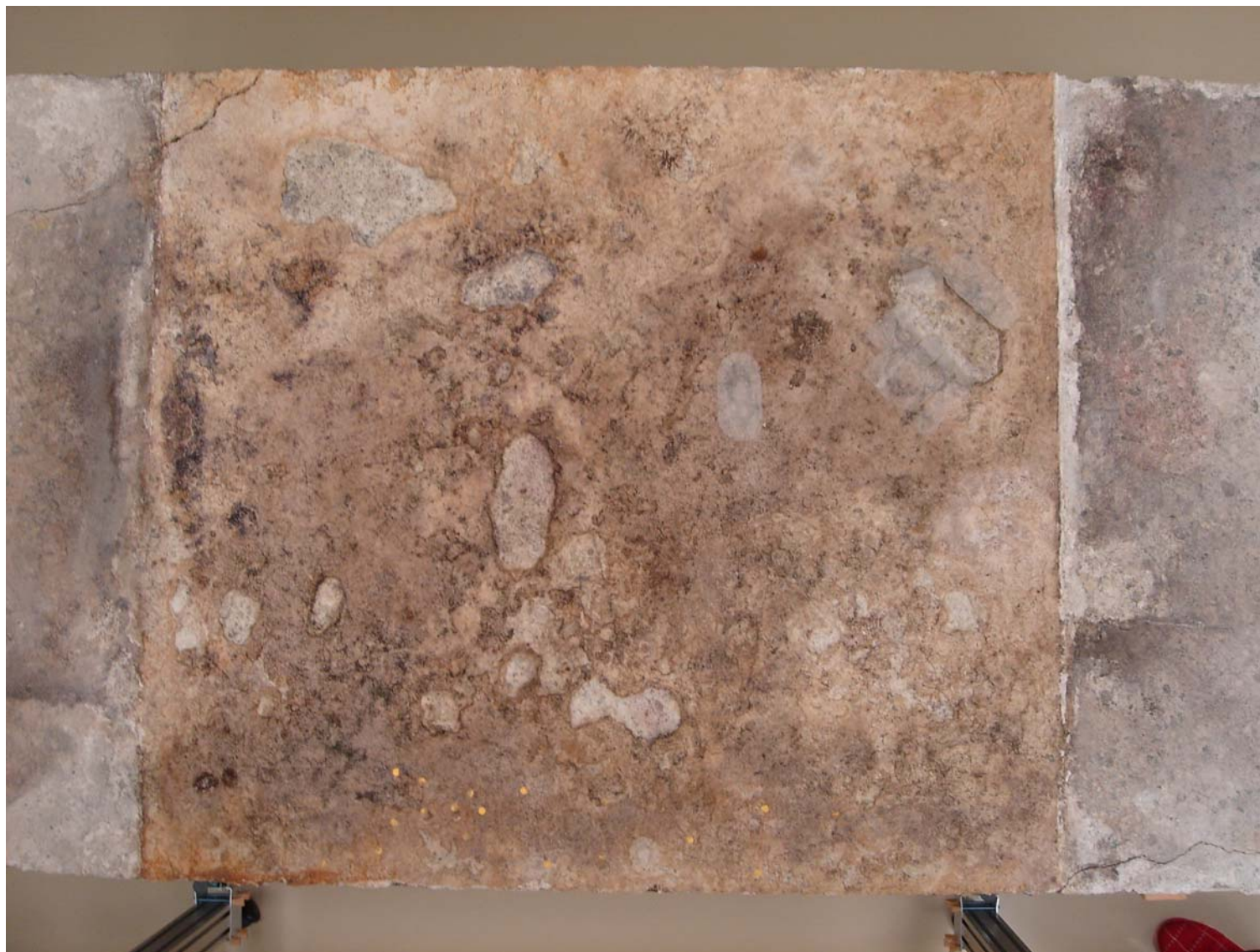
天3：漆喰層の剥落
