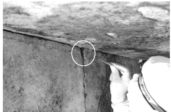
図 1.1. 天井石 3 の取り上げ時には、崩落する危険があった東壁石間の遊離石材を取り外した（漆喰は残存せず、すでに崩落していた）。
