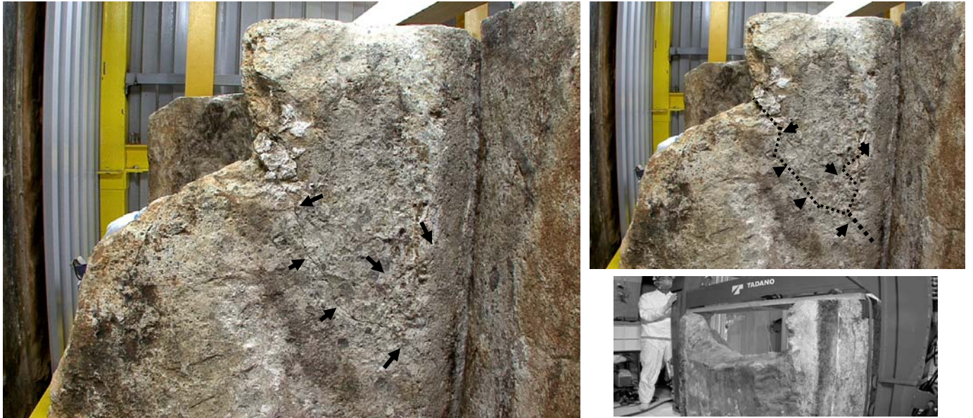
図 I-9. 南壁石の上部東側に見られる V 字形の亀裂は、不安定な状態になっており、ブロック状に崩壊する危険が極めて高い。石材の取り上げにあたっては、全体を拘束した。
