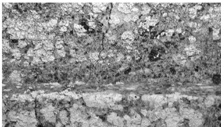
図1.8 床石2の亀裂は、相欠き部分で複雑な状態になっている。また、漆喰も多量に残存する
