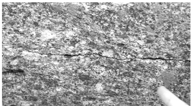
図 1.5. 床石 4 の底面に発生している亀裂
