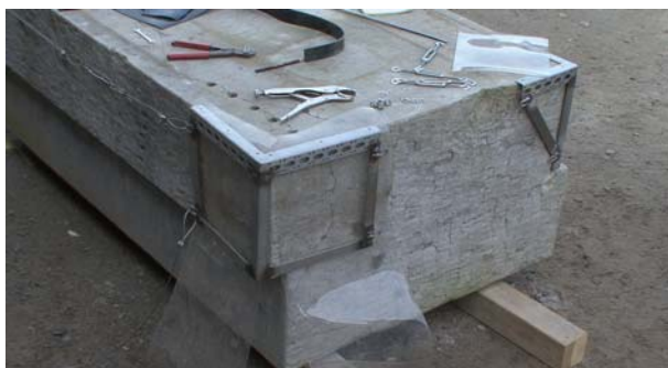
図 15. 両角部分のフレームが完了して、ビニールシート（アクリル板）を入れて保護する。
