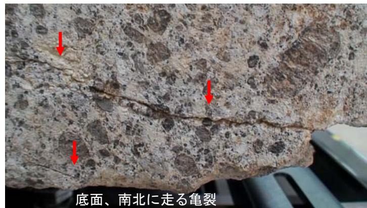
図4. ＜分類4＞ 石材を取り上げた後に発見された西側石の底面を南北に走行する亀裂。亀裂がどの程度石材の奥に潜り込んでいるか不明である。今後、このタイプの亀裂に対して面的な浮きの状態を調査する必要がある。
