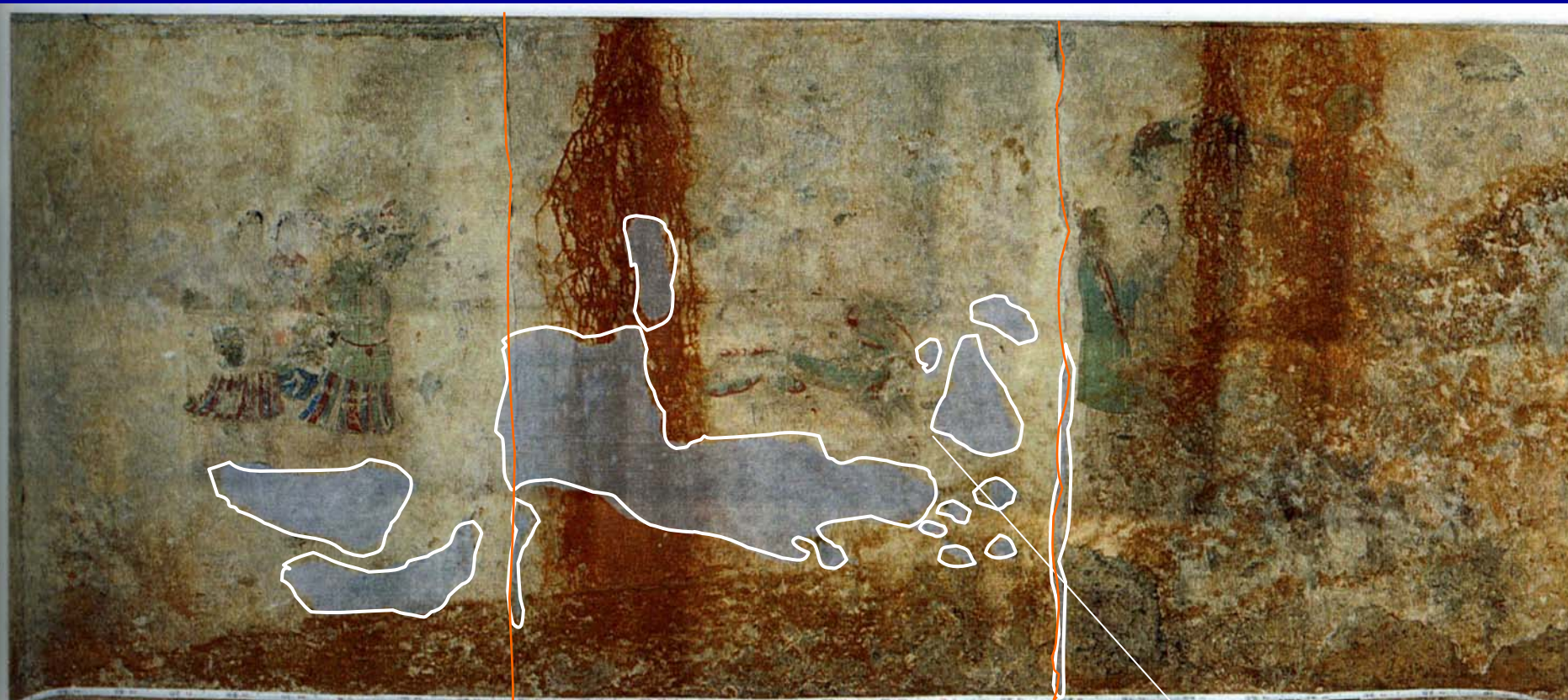
写真23 東壁カビ発生箇所
