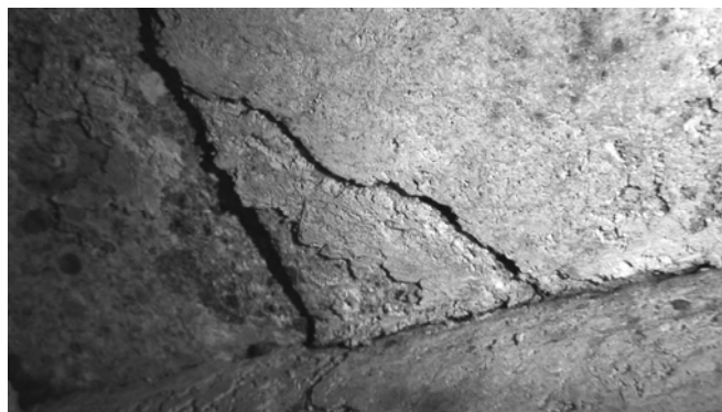
図 1.5 天井石4と東壁石3が接する部分にブロック状の緩やかなカーブを描く割れが見られる。北側はやや高く、天井石3はやや低い。
