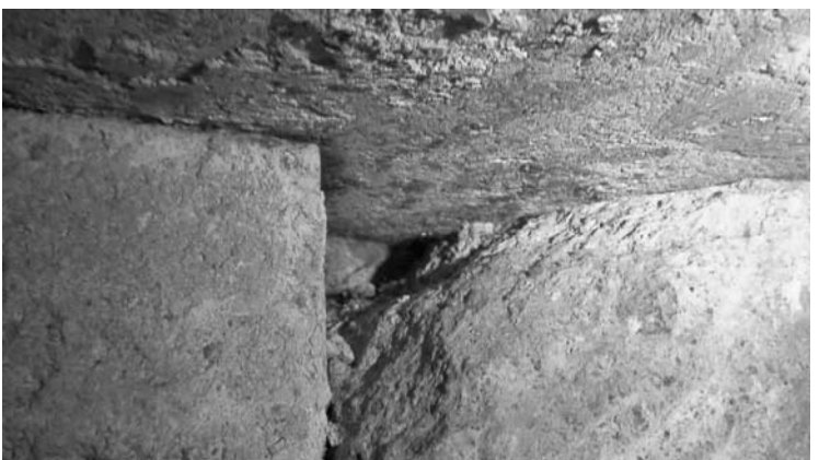
図1.16 南壁石を内部から見ると、東西の隅部分が大きく劣化している。
