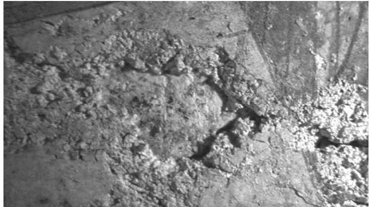
図1.14 絵画部分のブロック状、モザイク状の漆喰が崩落した跡は、粉状の漆喰が内部から観察されている。石材に接する漆喰の接着効果はほとんどないかもしれない。
