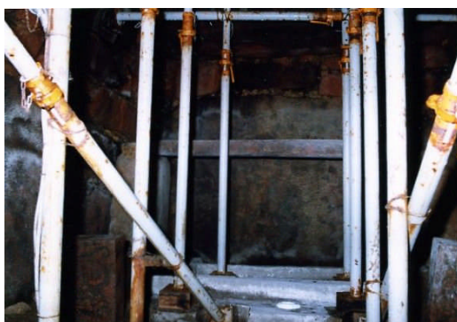
カビの発生した石室内
