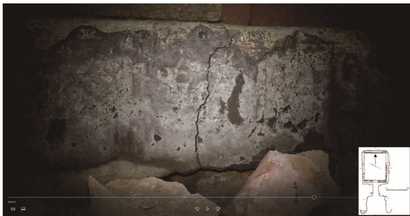
奥壁石障に生じた亀裂
