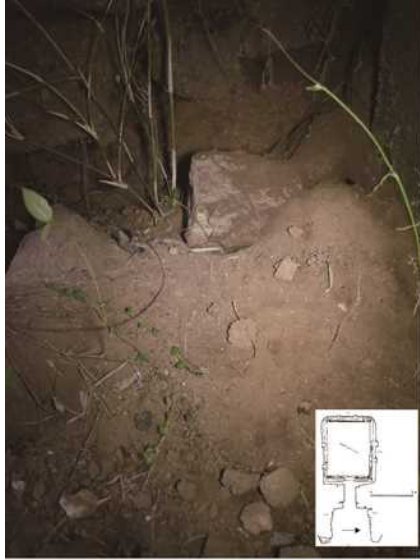
羨道南側壁面（土砂堆積）
