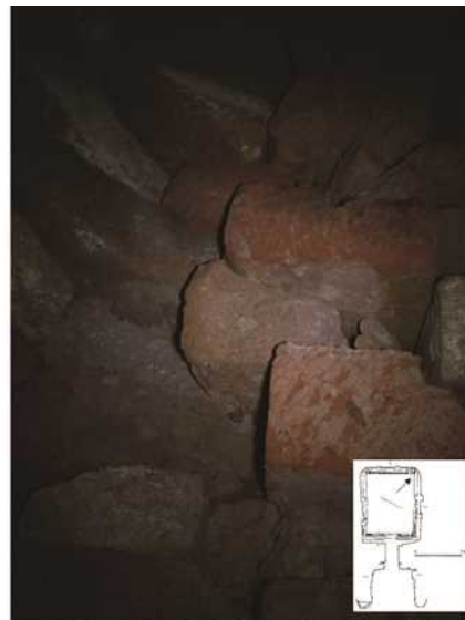
羨道南側壁（奥壁側）石材破碎・脱落
