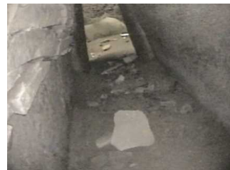
羨道部被災状況
