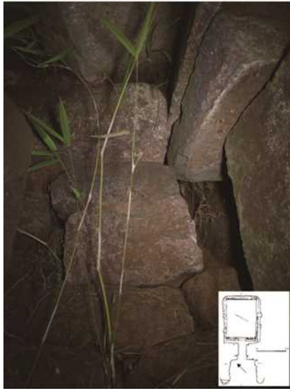
羨道北側壁面（袖石のずれ・傾斜）
