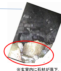
※玄室内に石材が落下。
