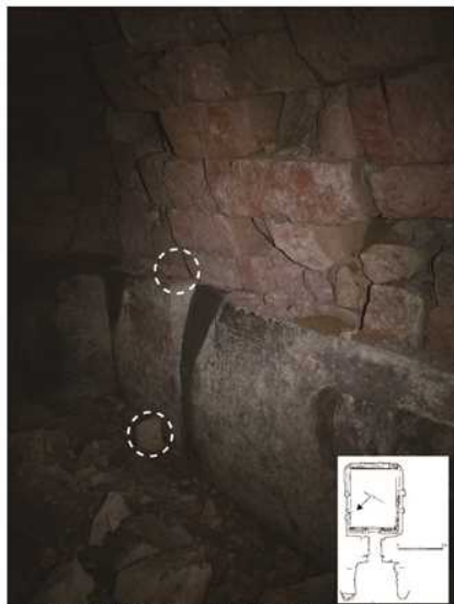
玄室北側壁②（刀置状突起破損・脱落）
