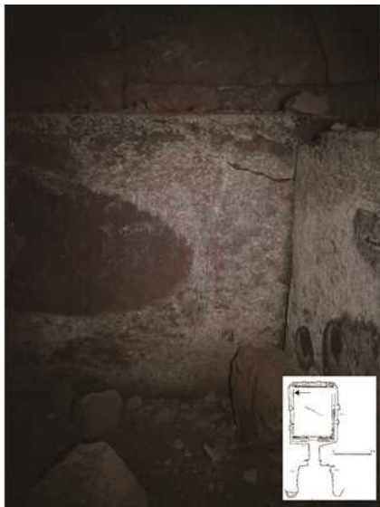
玄室北側壁（奥壁側）龜裂
