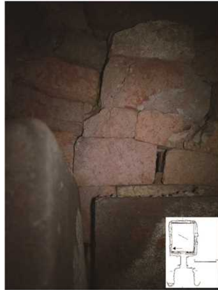
玄室北側壁面（石材破碎・脱落）
