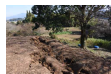
亀裂の拡大(頂上→東側)
