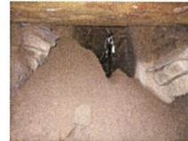
入口部分の流入土
