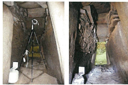
地震でせり出した前室の壁 (左が地震前、右が地震後)
