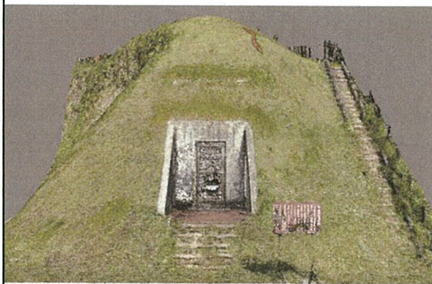
墳丘亀裂部(南→北)
