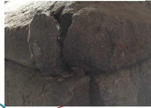
石棺妻入（裏面）角破碎状況
