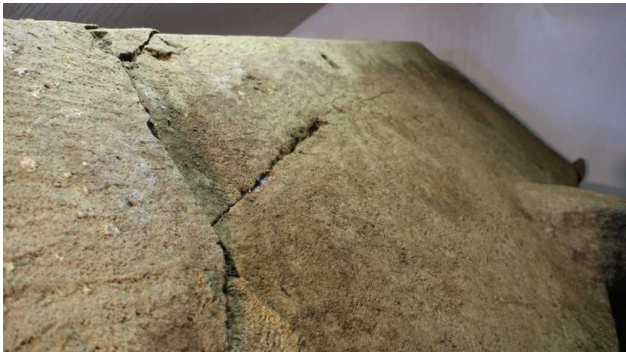
蓋石(右側)ひび割れが拡大
