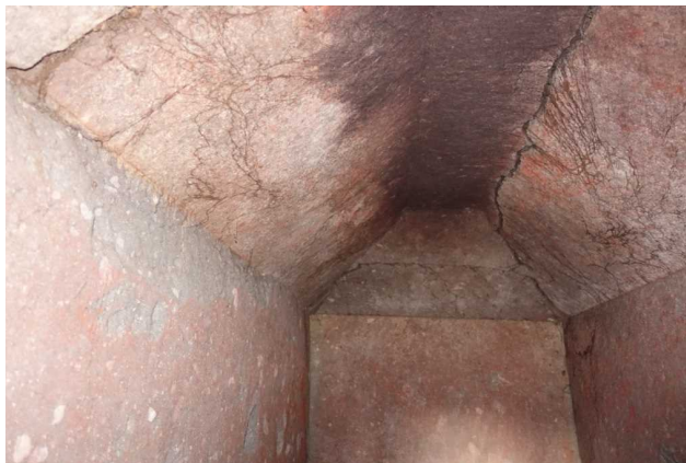
石棺内壁 蓋石の稜線にひび割れ
