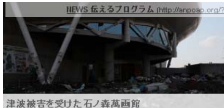
津波被害を受けた石ノ森萬画館
