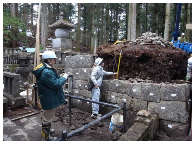
日光輪王寺慈眼堂廟塔の復旧工事(財団法人日光社寺文化財保存会提供)
