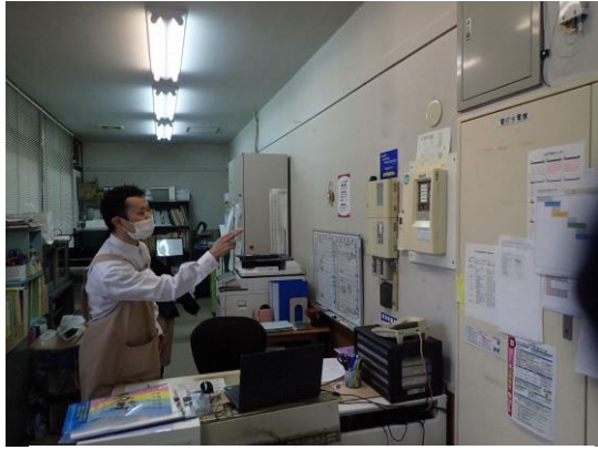
火災報知機の受信機で出火場所を確認
