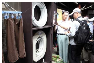
屋外易操作性消火栓
