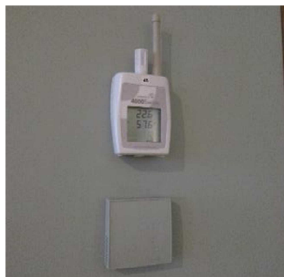
展示室の壁に設置されたポータブル・データロガー (上) とビルディング・センサー (下)
