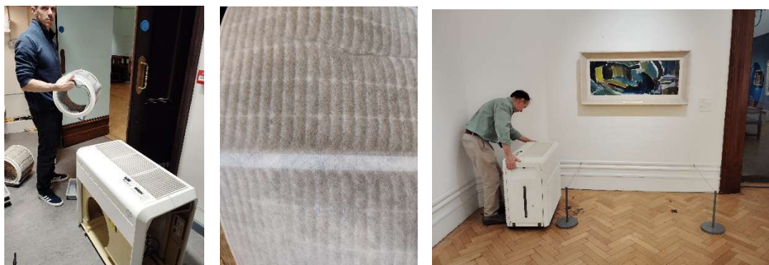
加湿器のメンテナンス作業（左）、フィルターの汚れ（中央）、メンテナンス済みの加湿器の再設置（右）
