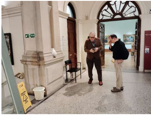
最上階の彫刻展示室で柱をつたう雨漏り発生時、 建物管理専門家と展示室で話し合う
