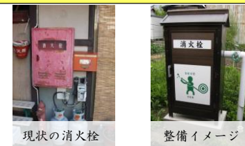
現状の消火栓
