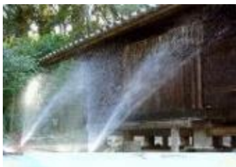
（ドレンチャー設備）
