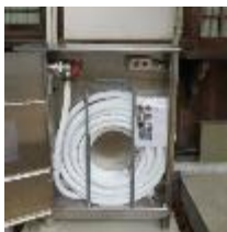
（易操作性1号消火栓）
