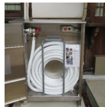
(易操作性1号消火栓)
