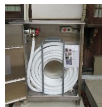
(易操作性1号消火栓)
