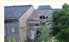
木造空き屋の劣化進行対策
