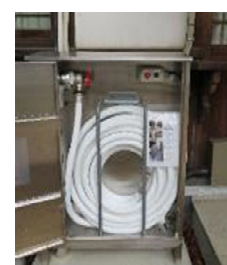
(易操作性1号消火栓)
