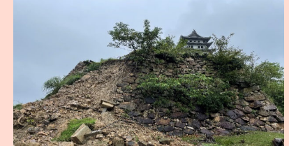
整備が遅れて石垣が崩落
