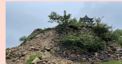
整備が遅れて石垣が崩落
