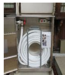
(易操作性1号消火栓)
