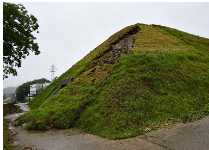
史跡 与楽古墳群 （奈良県高取町） 令和5年6月豪雨による土砂の崩落
