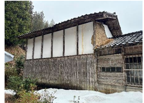
重要文化財黒丸家住宅米蔵ほか （石川県珠洲市） 令和6年1月能登半島地震による土壁の剥落
