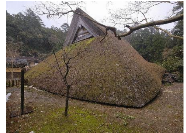
重要文化財 上時国家住宅主屋ほか （石川県輪島市） 令和6年能登半島地震による主屋などの倒壊
