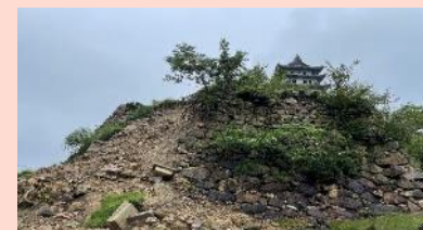
整備が遅れて石垣が崩落
