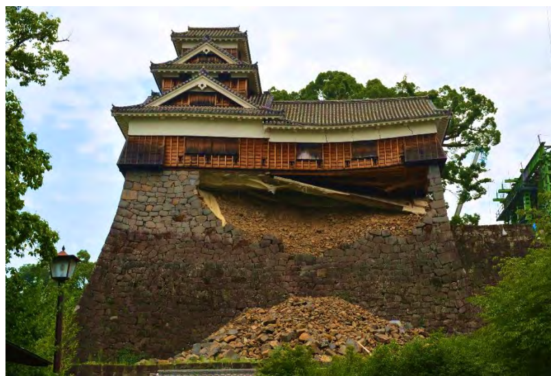
熊本城石垣の地震被害
