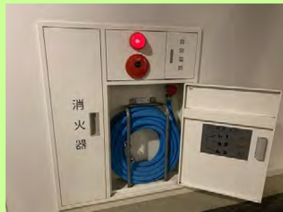
防火施設の設置
