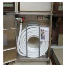
(易操作性1号消火栓)
